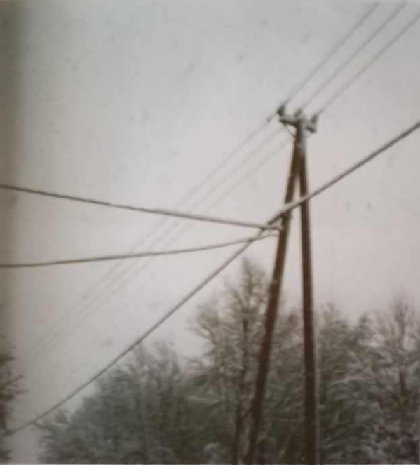
Linia dwunapięciowa z przewodami izolowanymi SN-nn na słupach drewnianych (Beskidzka Energetyka SA)
