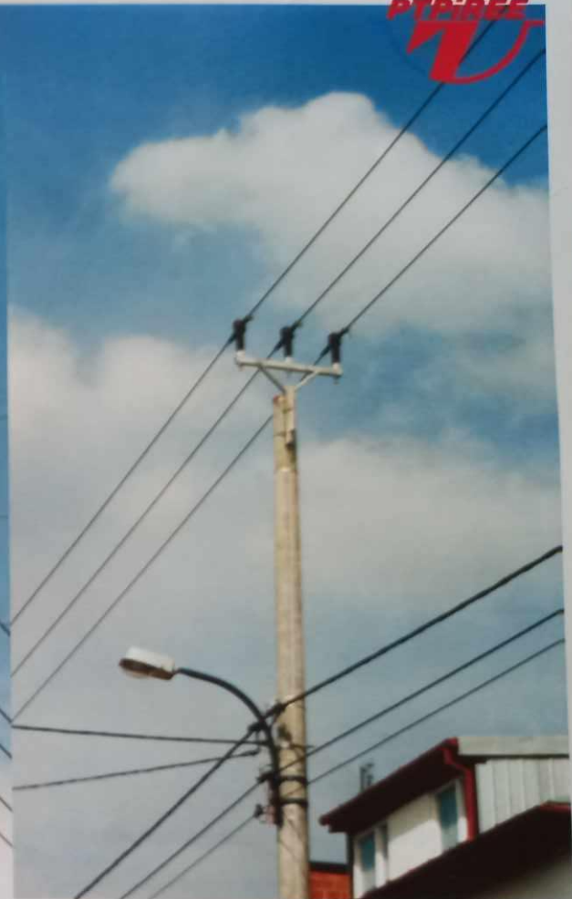
Linia dwunapięciowa z przewodami izolowanymi SN-nn na słupach wirowanych (STOEN SA)
