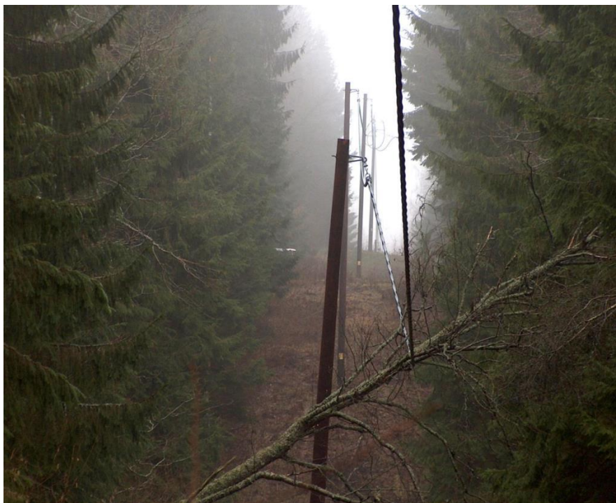
Rys. 5. Linia izolowana SN (kabel uniwersalny typu AXCES) w lesie
