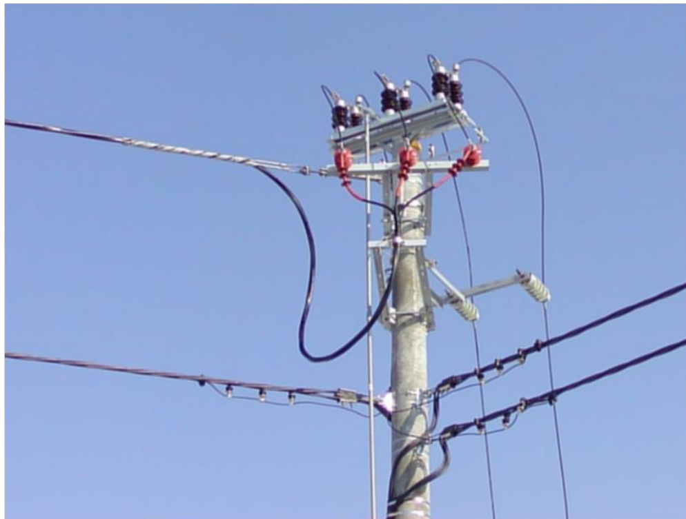
Przewody uniwersalne w linii SN i linie izolowane nn
